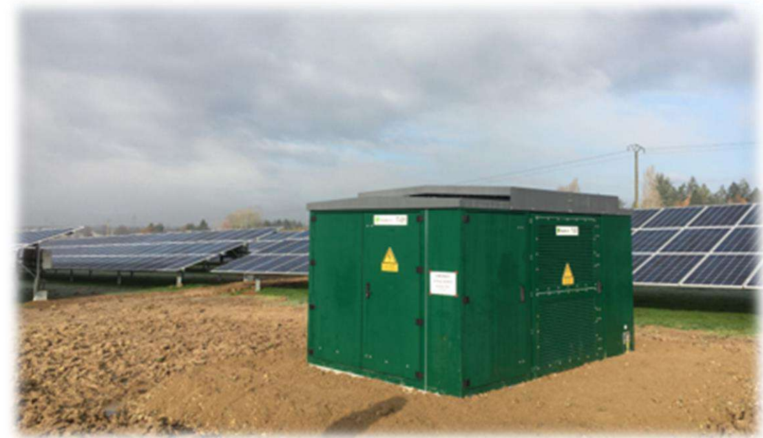
Poste de transformation
